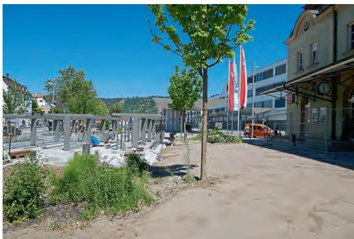
Die modernen Fahrradabstellanlagen am Eichstätter Bahnhof sind nun fertig. Insgesamt sind auf der Fläche zwischen Bahnhofsgebäude und Weissenburger Straße 96 Fahrradparkplätze mit Überdachung und neun abschließbare Fahrradkäfige entstanden. In den Fahrradkäfigen gibt es auch jeweils einen Ladeanschluss für E-Bikes.
